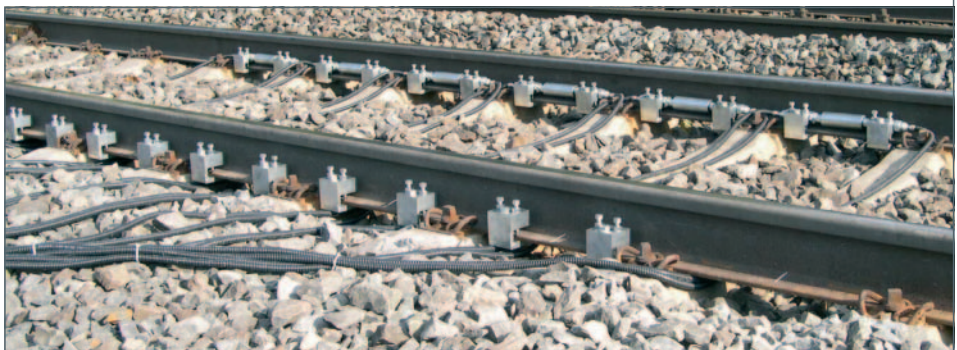
BILD 3: Gesamtaufbau eines Messsystems mit 12 Sensoren, jeweils an der Innenseite der Schiene
